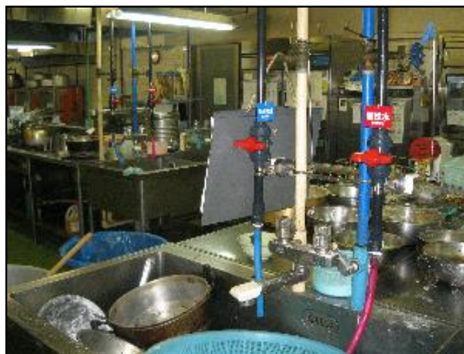
取水口(調理室)
