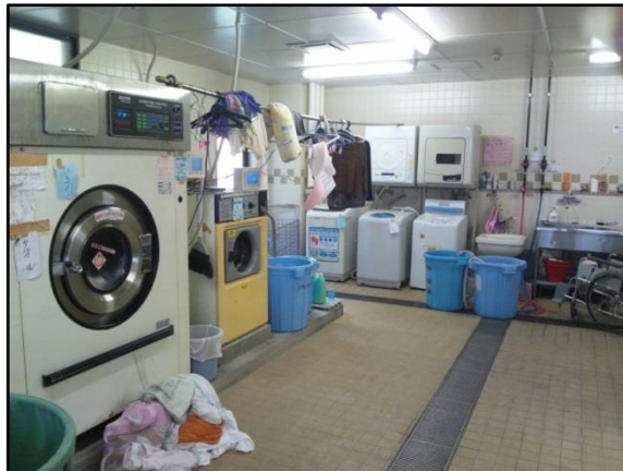
特別養護老人ホーム 愛知県西尾市 ESS-300 ・業務用洗濯機×1台、汚物除去機×1台に接続。 ・汚物の臭気が無くなりスタッフからの評価は高い。
