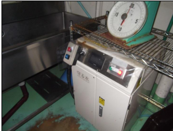
病院 長野県飯田市 ESS-ZERO ・厨房にて活用 ・食中毒に対しての衛生管理を徹底している。
